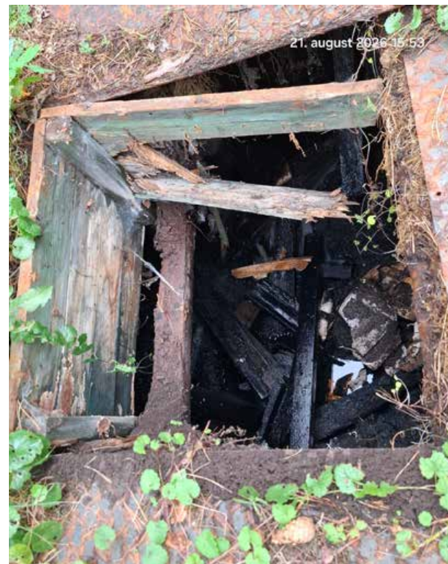
Näide kontrolli käigus leitud amortiseerunud reoveemahutist, mille puhul ei ole välistatud reovee sattumine pinnasesse ja põhjavette
